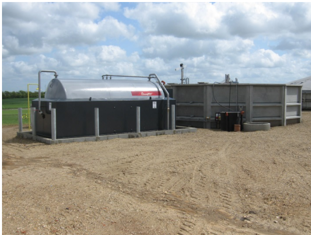
Figur 3. Forsuringsanlægget "JH Forsuring NH4+" ved lokalitet B.
