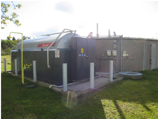
Figur 1. Forsøringsanlægget “JH Forsuring NH4+” ved lokalitet A.
